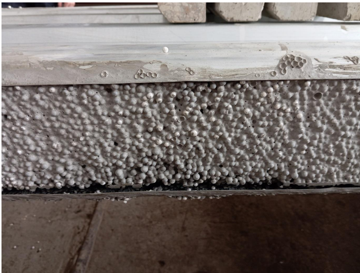
Рис. 5.9 Характер разрушения опытного образца
